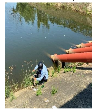
Hình 6: Trạm bơm Tứ Cầu
