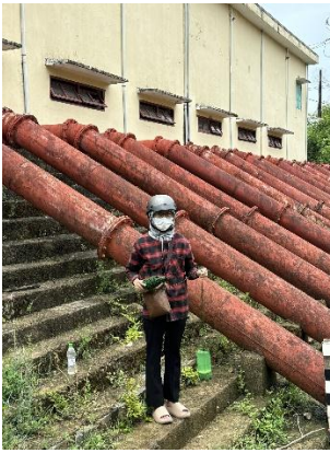
Hình 5. Trạm bơm Đông Quang
