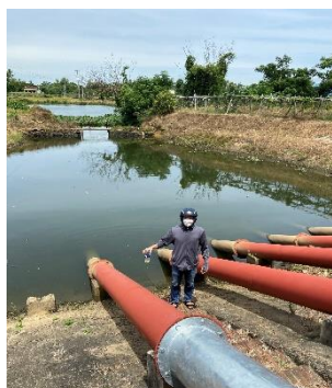
Hình 4: Trạm bơm Tứ Cầu
