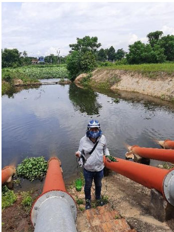
Hình 4. Trạm bơm Tứ Cầu
