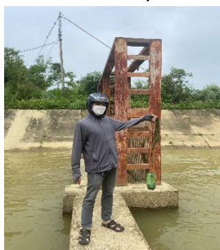
Hình 4: Trạm bơm Đông Quang
