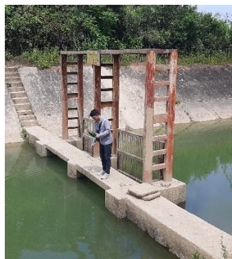
Hình 4. Trạm bơm Đông Quang
