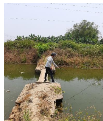
Hình 3: Trạm bơm Tứ Câu
