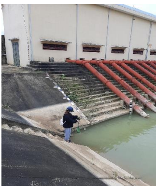
Hình 5: Trạm bơm Đông Quang
