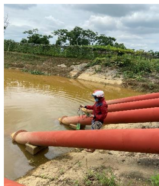
Hình 4: Trạm bơm Tứ Cầu
