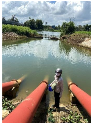
Hình 5. Trạm bơm Tứ Cầu
